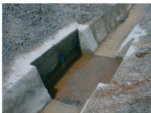
Figuras 6 y 7. Fotografías de los puntos de desagüe realizadas meses después de la instalación del sistema drenante.
